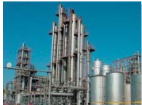
高圧ガス設備
