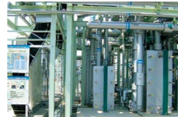
水和スラリー設備
